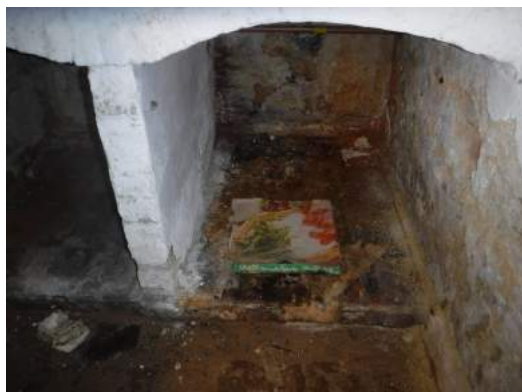
organisch materiaal met schimmelvorming
