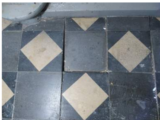
Losliggende en verzakte tegels
