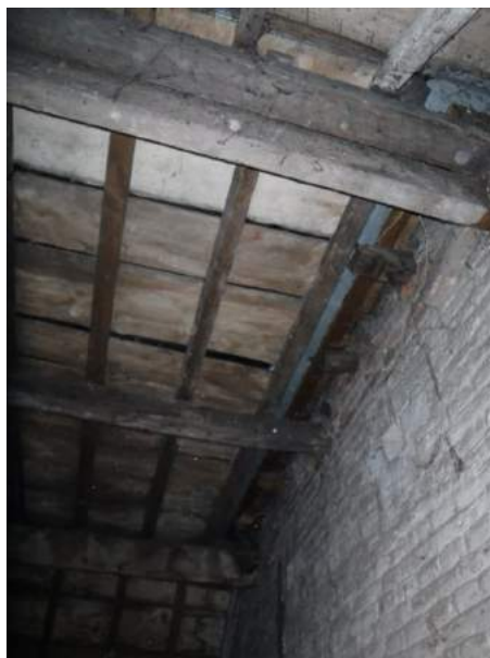
vochtsporen op bebording en aansluiting plat dak
