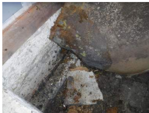
organisch materiaal met schimmelvorming
