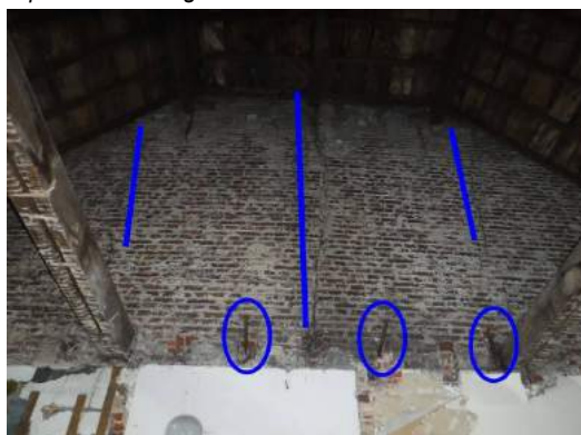
verwijderde vloer / losse muurankers binnen / verticale scheuren
