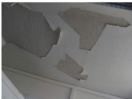
Op het plafond in een kamer op de eerste verdieping zijn grote stukken afgevallen.
