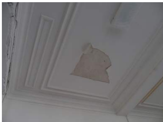
Plaatselijke ontbreekt het vlakke pleisterwerk in de grote kamer op het gelijkvloers.
