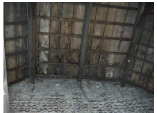
vochtsporen op bebording en aansluiting plat dak
