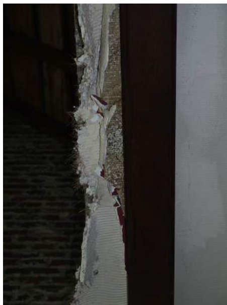
Resten van het gestucte plafond in de aanbouw (kant gemeentehuis).
