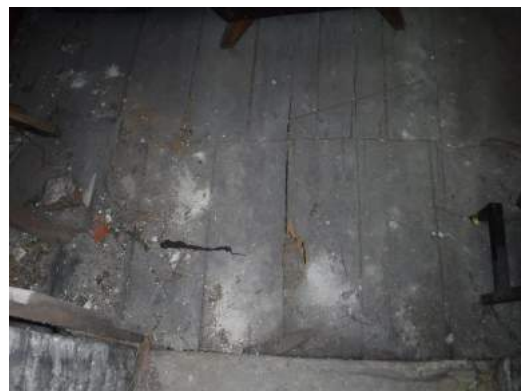
beschadigde beplanking zoldervloer
