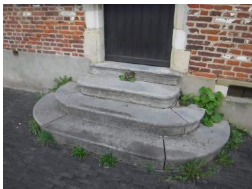
ontbrekend voegwerk buitentrapp
