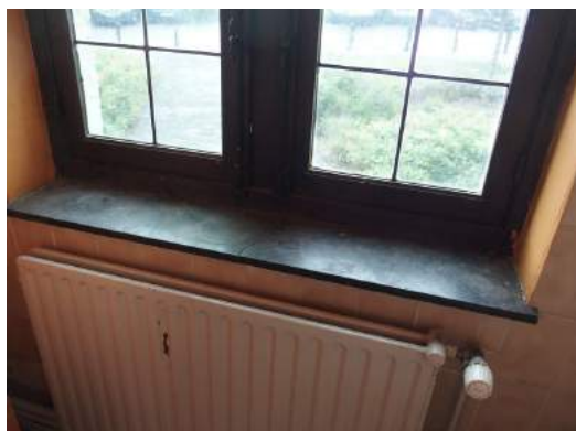
Bij de meeste ramen zijn er nog eenvoudige venstertabletten aanwezig.
