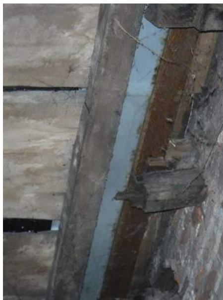
vochtsporen op bebording en aansluiting plat dak
